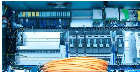
Kabeltechnik, Schaltschrankbau, Mechatronik
