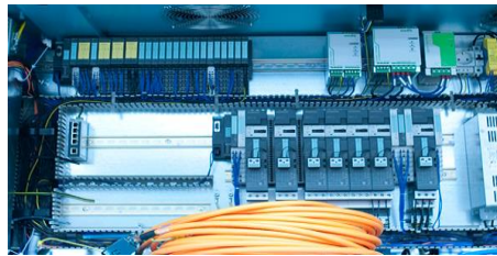
Kabeltechnik, Schaltschrankbau, Mechatronik
